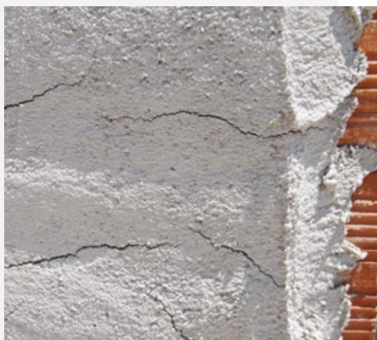
L'irraggiamento solare diretto in asciugatura può causare la formazione di crepe nell'intonaco
