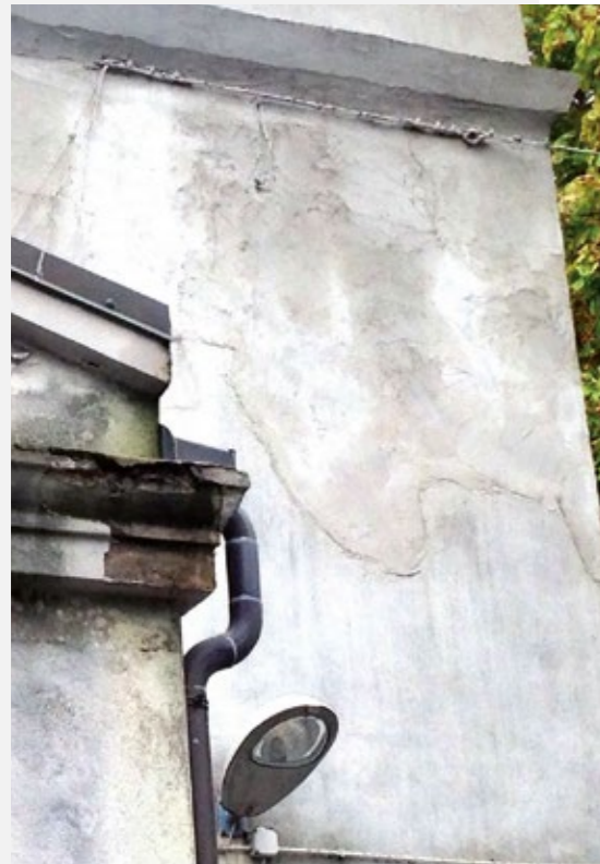
Irregolarità superficiali sulla facciata di un vecchio palazzo.
