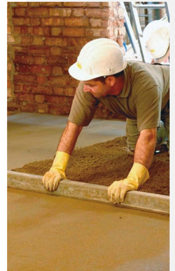
La progettazione di un buon sistema flooring inizia dal massetto.
