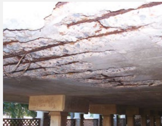
Soffitto mediamente danneggiato
