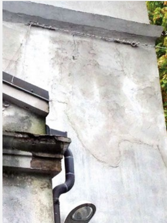
Irregolarità superficiali sulla facciata di un vecchio palazzo
